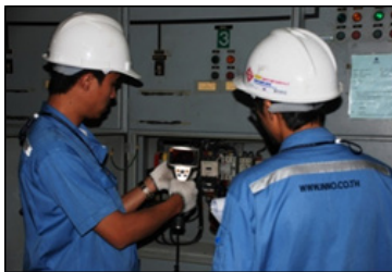
รูปแสดงการตรวจสอบอุปกรณ์ในตู้ไฟฟ้า
