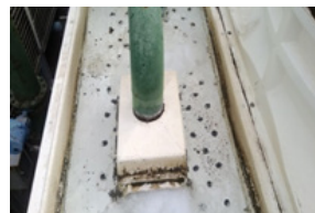
รูปที่ ถาดน้ำขาเข้าด้านบนห้องฟื้น ปราศจากตะไคร่น้ำ
