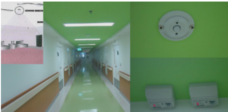
แสดงการติดตั้งอุปกรณ์ควบคุมกำลังไฟฟ้าสำหรับแสงสว่าง โดยไมโครโปรเซสเซอร์
