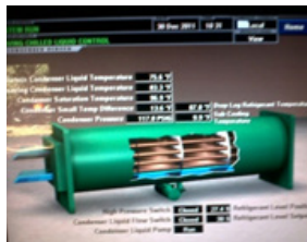
รูปที่ Chiller No.6 พบค่า condenser approach temperature = 13.6 F
