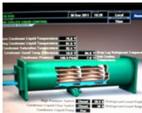
รูป Chiller No.5 พบค่า condenser Approach Temperature = 10.9 F
