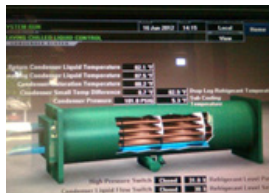
รูปที่ chiller No.6. condenser approach temperature = 0.7 F
