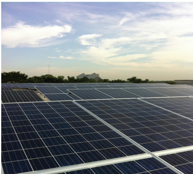
รูปที่ 3.52 ตัวอย่างโครงการ Grid-Connected PV Solar Roof Top ณ อาคารอนุรักษ์พลังงานเฉลิมพระเกียรติ
