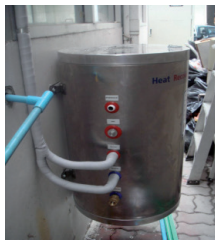
ถังน้ำแลกเปลี่ยน ความร้อน (PAC)
