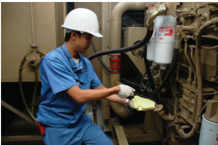
รูปที่ 3.60 แสดงการตรวจสอบสารหล่อลื่นเครื่องจักร
