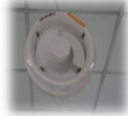
พัดลมระบายอากาศ กินไฟ 28 วัตต์/ตัว
