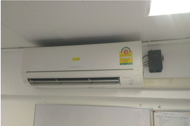
รูปที่ 3.63 แสดงเครื่องปรับอากาศที่ติดตั้งชุดตรวจสอบประสิทธิภาพแบบ Realtime Air Conditioning Performance Indicator (ACPI)
