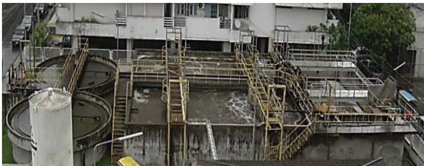
รูปที่ 2.26 แสดงระบบบำบัดน้ำเสียโรงพยาบาล หาดใหญ่
